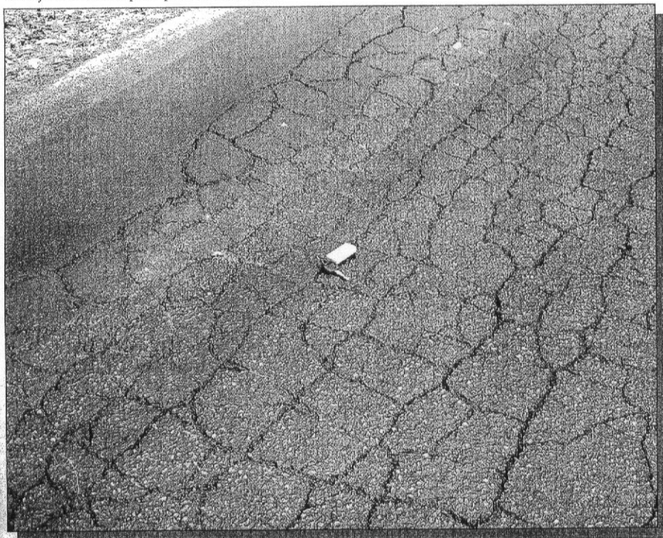
Stato fessurativo del tipo a "pelle di cocodrillo".
