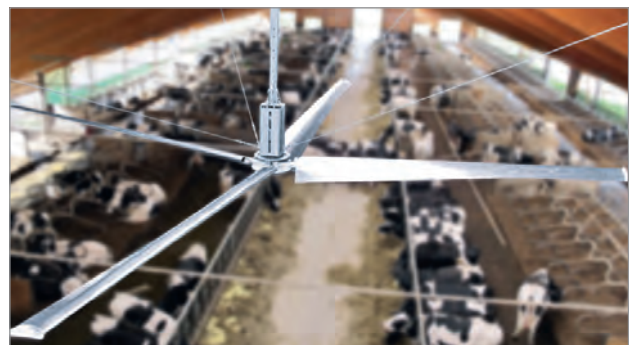
Широкозахватный вентилятор VENTITEC® в животноводческом помещении
